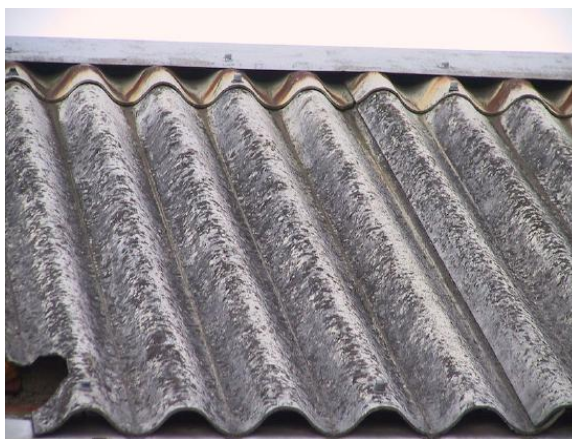
Figure 4.3.3: Corrugated asbestos roof. Image courtesy of de.Wikipedia.org/wiki/Benutzer:Hawedi
